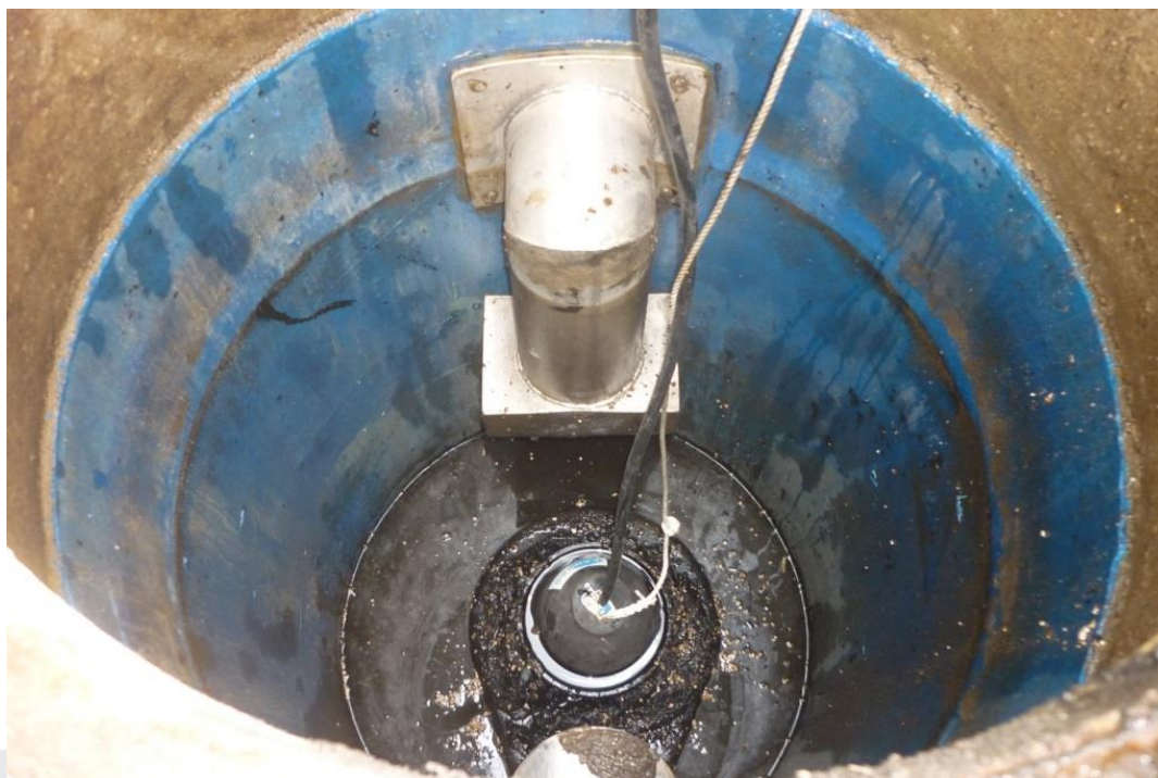
Foto: Afsluiter in afscheiderinstallatie.
