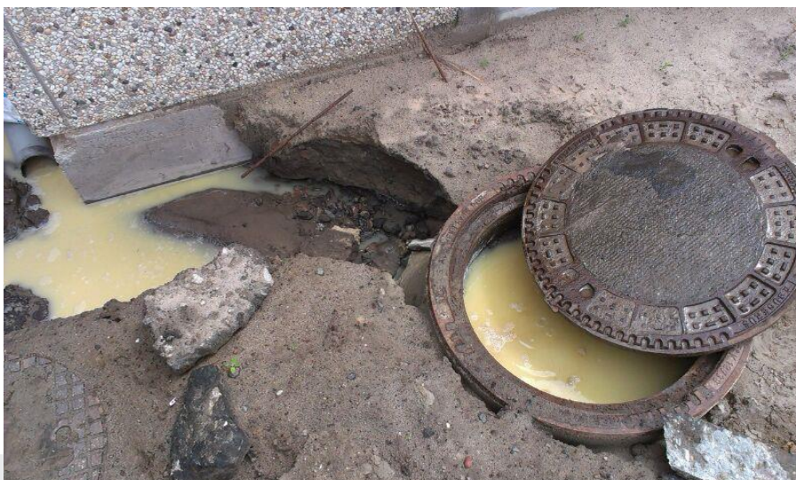
Foto: Verzakking ter plaatse van riolering.
