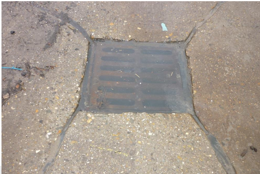
Foto: Ontvangpunt tot bovenzijde gevuld met water.
