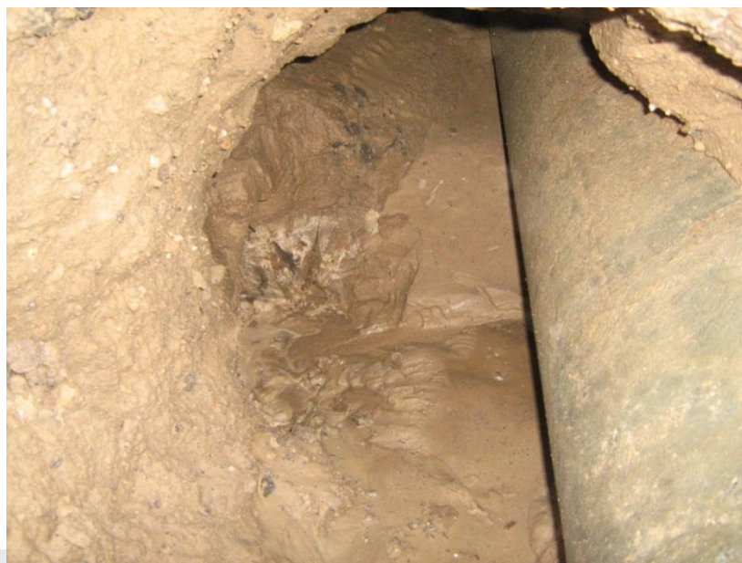
Foto: Lekkage leidingwerk.
